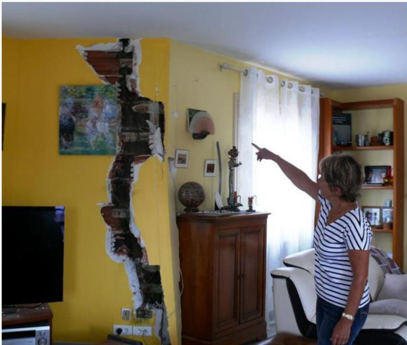
Martine Peyrard montre les dégâts causés par la foudre dans son salon à Saint-Cirq./Photo DDM André Ramoneda
